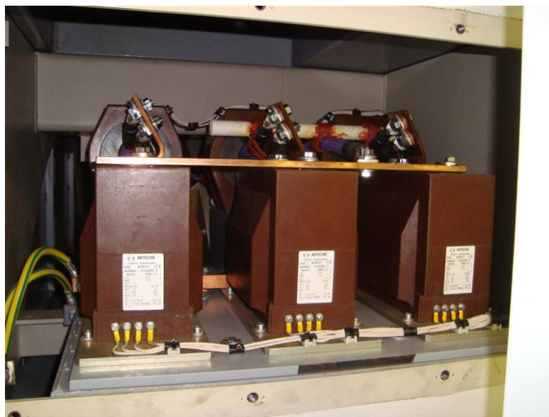
Slika 2.5: Mjerni transformatori napona i struje sinkronog generatora
