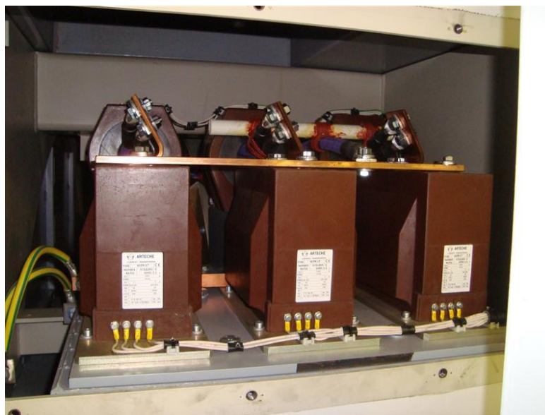
Slika 2.5: Mjerni transformatori napona i struje sinkronog generatora
