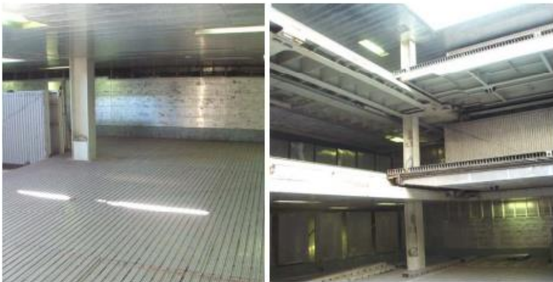
Slika 8. Unutrašnjost broskog rashladnog skladišta 30
