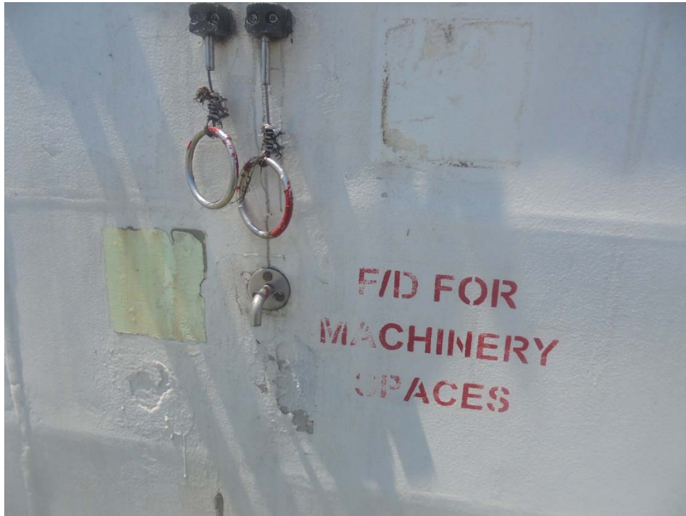
Slika 18. Sigurnosne sajle za ventilatore strojarnice
