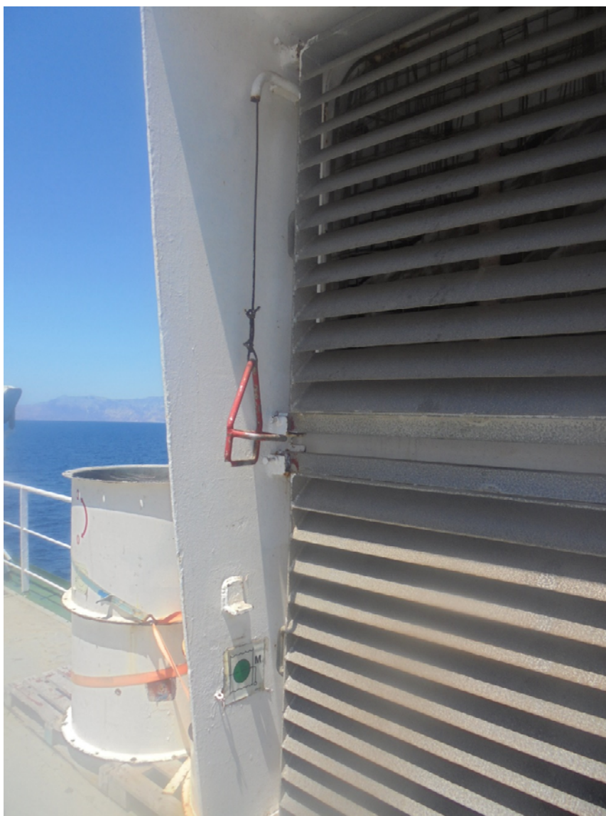
Slika 15. Prikaz ulaza zraka u ventilator za strojarnicu
