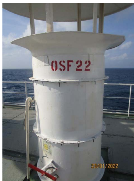
Slika 49. Klapna u slučaju požara obojana crvenom bojom
