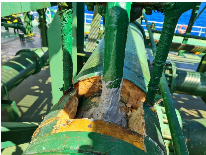
Slika 6. Izolacija cjevovoda para tereta; Izvor: arhiva autora
