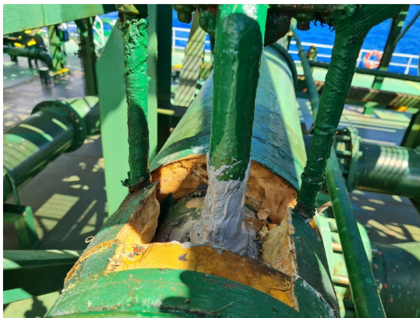
Slika 6. Izolacija cjevovoda para tereta; Izvor: arhiva autora
