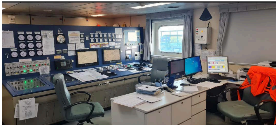
Slika 13. kontrolna soba tereta na LPG brodu; Izvor: arhiva autora
