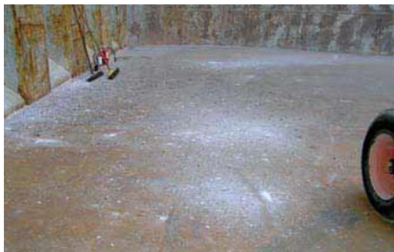
Slika 42. Ostaci tereta koji su pali u skladište nakon nekoliko otvaranja i zatvaranja poklopaca skladišta
