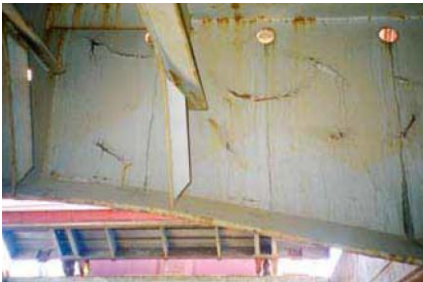
Slika 18. Otpadanje boje na gornjim dijelovima skladišta može rezultirati odbijanjem skladišta za ukrcaj
