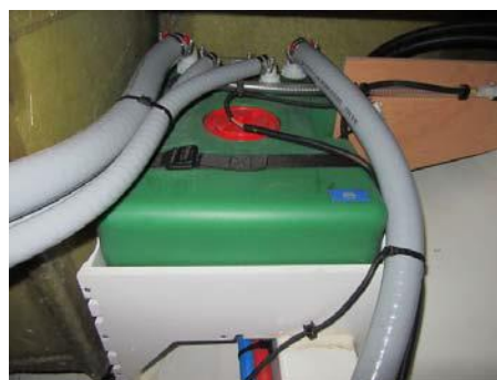
Slika 30. Tank sive vode [3]
