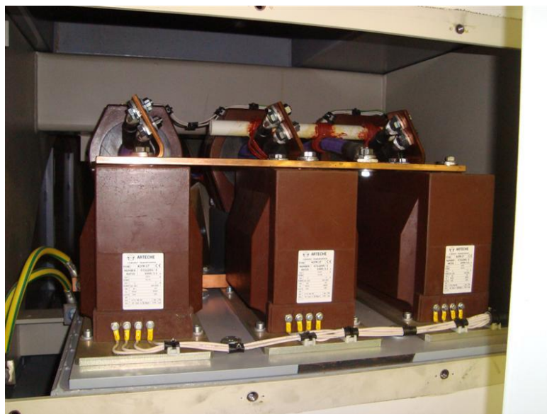
Slika 2.5: Mjerni transformatori napona i struje sinkronog generatora
