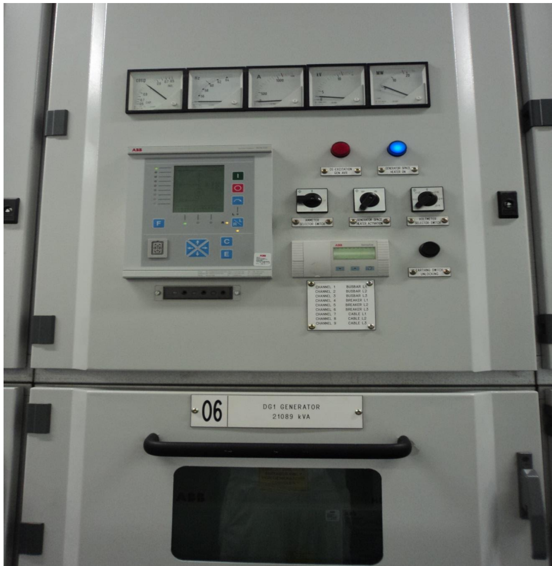
Slika 2.7: Polje generatora br.1 na glavnoj sklopnoj ploči
