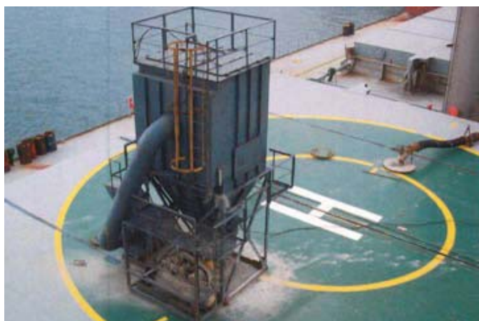
Slika 14. Ukrcaj cementa zatvorenim sustavom.
