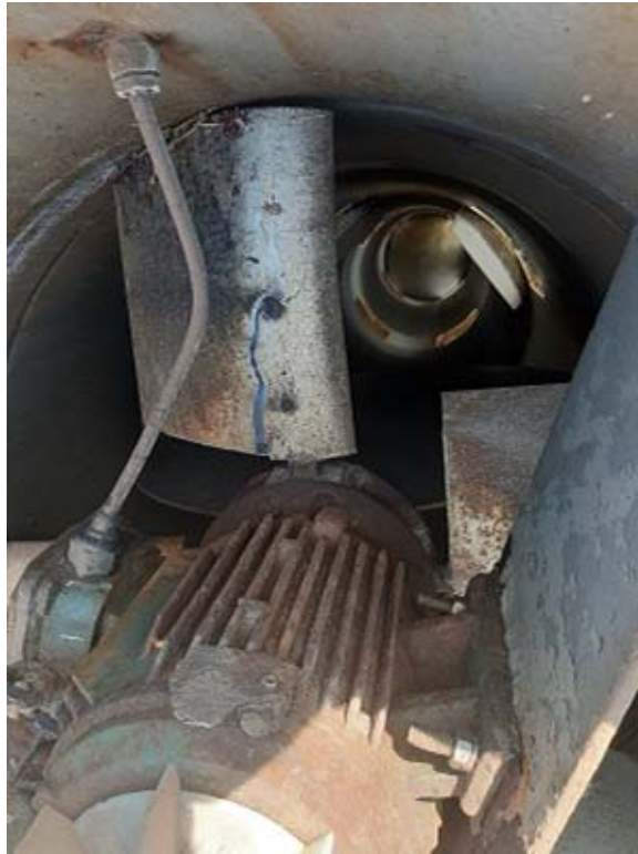
Slika 31. Prikaz puknuća impelera
