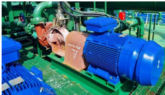
Slika 14. Pomoćne pumpe tereta na LPG brodu; Izvor: arhiva autora
