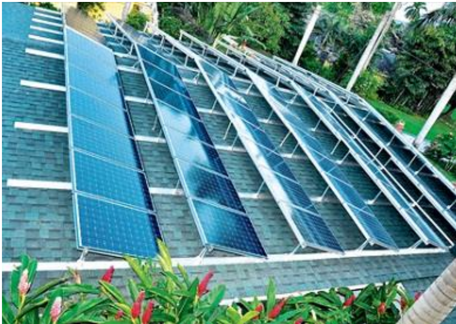
Slika 5.: Solarni paneli u hotelu
