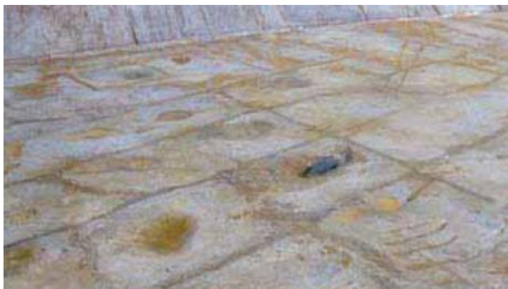
Slika 9. Potrebno je provjeriti udubljenja na pokrovu dvodna poslije iskrcaja i poslije čišćenja
