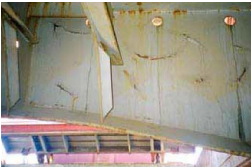
Slika 18. Otpadanje boje na gornjim dijelovima skladišta može rezultirati odbijanjem skladišta za ukrcaj
