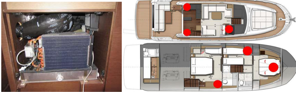
Slika 35. Izgled i smještaj ventilatora po prostorijama [3]
