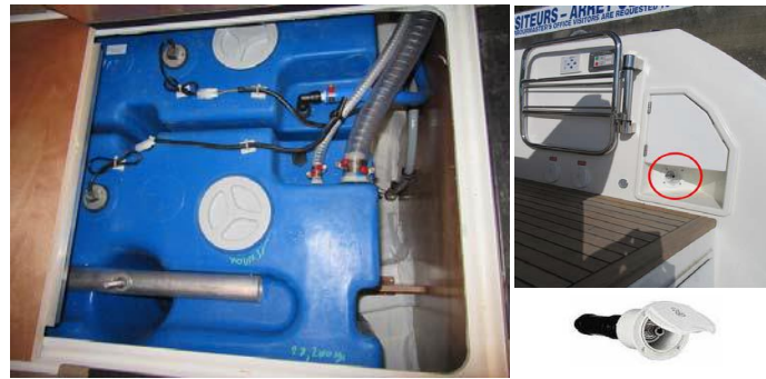
Slika 27. Tank vode i priključak vodu s kopna [3]
