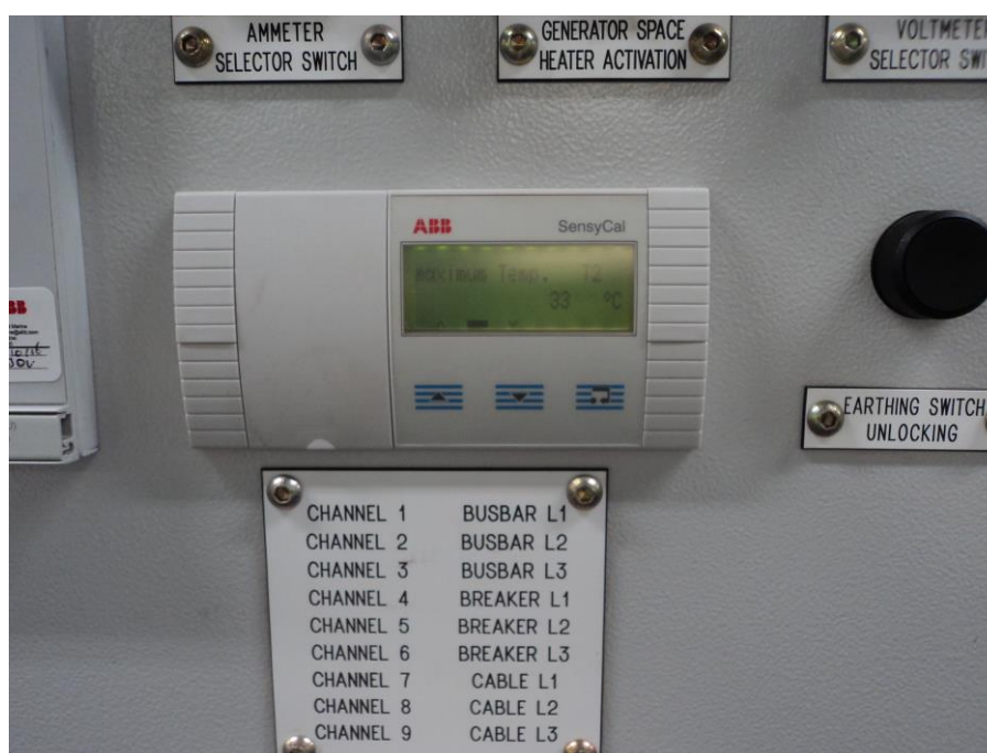
Slika 3.8: Nadzor temperature polja generatora glavne sklopne ploče
