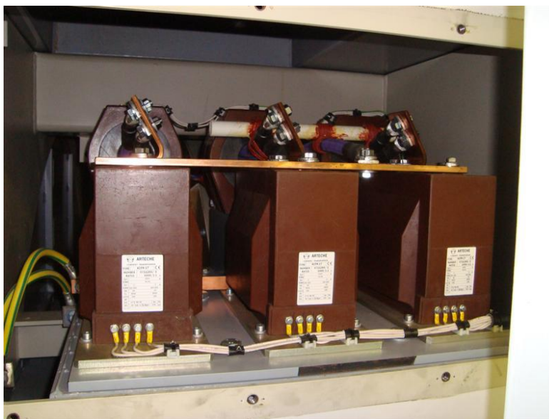
Slika 2.5: Mjerni transformatori napona i struje sinkronog generatora
