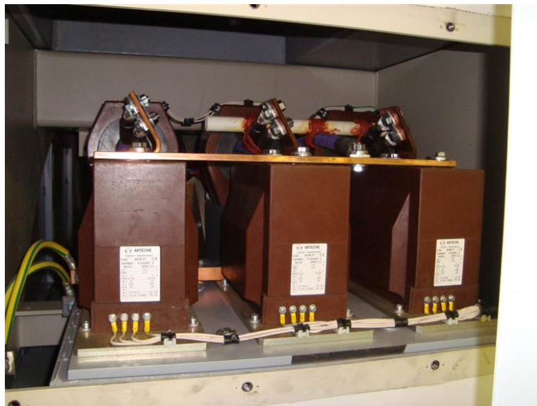
Slika 2.5: Mjerni transformatori napona i struje sinkronog generatora
