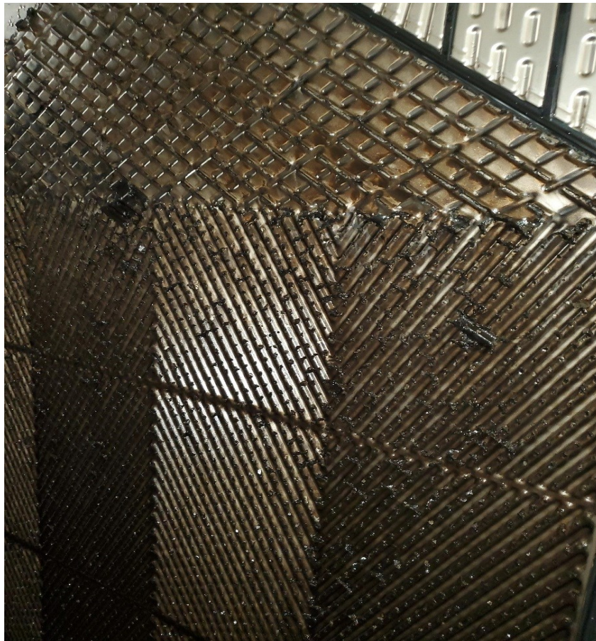
Slika 32. Onečišćena ploča izmjenjivača topline.[11]
