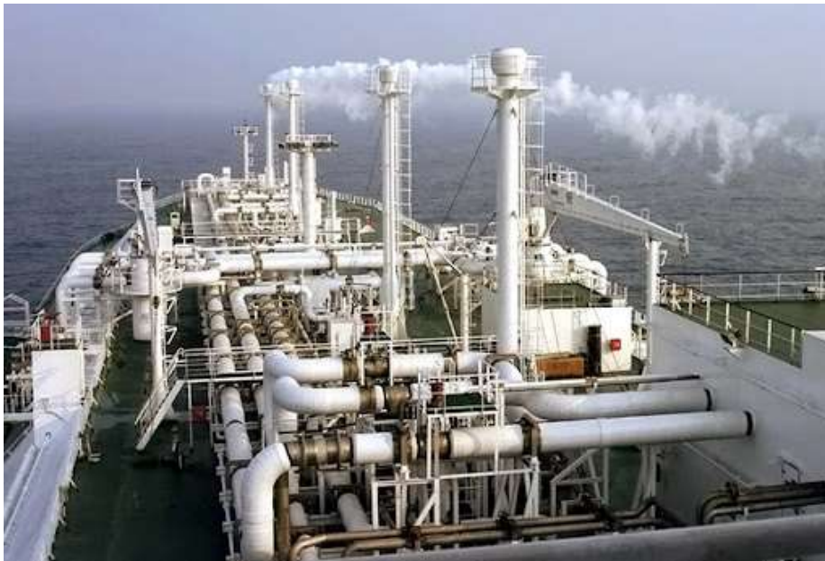
Slika 17. Cjevovod na LNG brodu [2]
