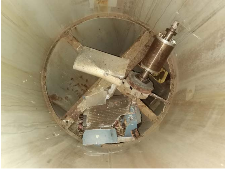
Slika 35. Prikaz puknuća impelera i elektromotora
