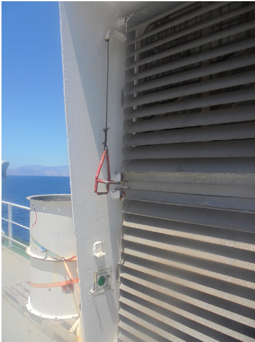
Slika 15. Prikaz ulaza zraka u ventilator za strojarnicu
