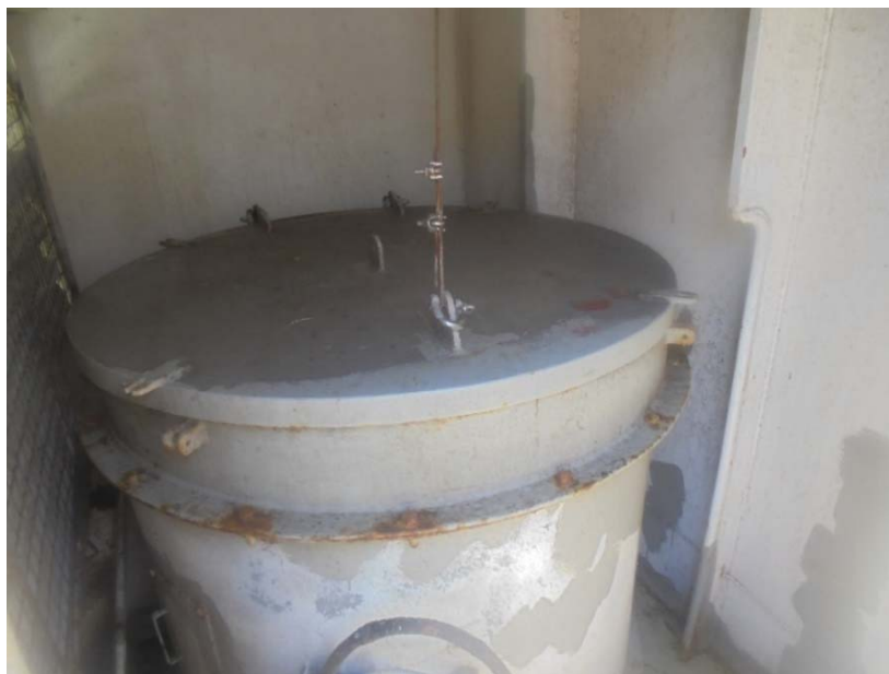
Slika 19. Prikaz zatvorenog poklopca ventilatora strojarnice
