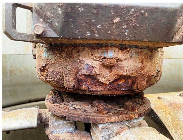
Slika 34. Korozija impelera i elektromotora
