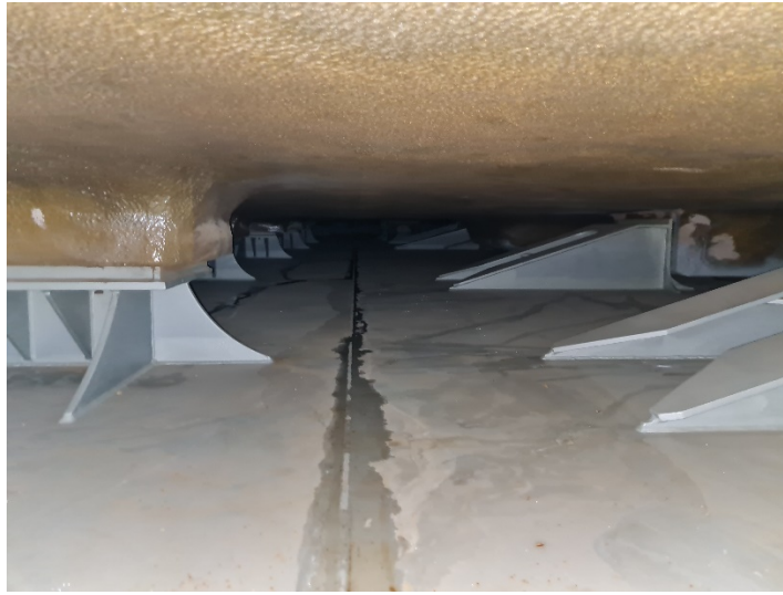
Slika 10. Prostor između spremnika tereta i balastnih spremnika (engl. cargo hold space ); Izvor: arhiva autora
