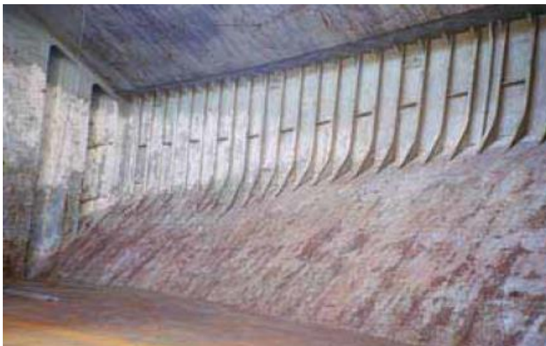
Slika 34. Slobodna korozija mora biti uklonjena
