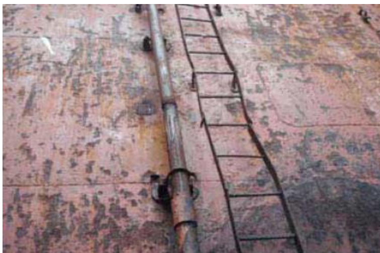
Slika 19. Skladišta neće proći inspekciju za ukrcaj žita ako imaju velike količine korozije izmiješane su sa mrljama od ugljena
